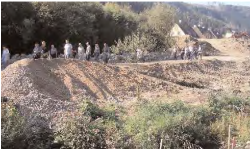
Bürger aus der Nahmer und dem Wessalbachtal verschaffen sich einen Eindruck vom Baufortschritt am Koenigsee
