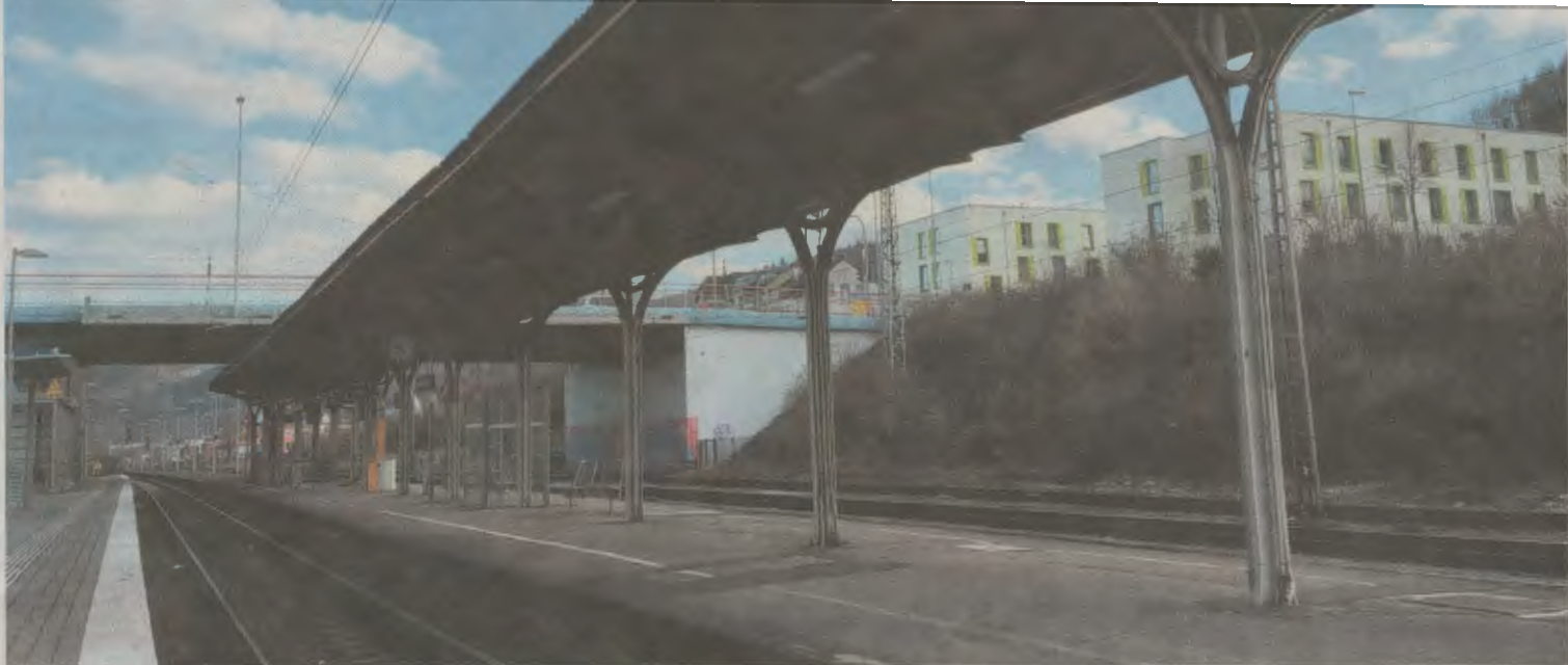
Das Bahnsteigdach am Bahnhof in Hohenlimburg soll im Zuge der Sanierung abgerissen werden. Das sagt bislang jedenfalls die Bahn.
